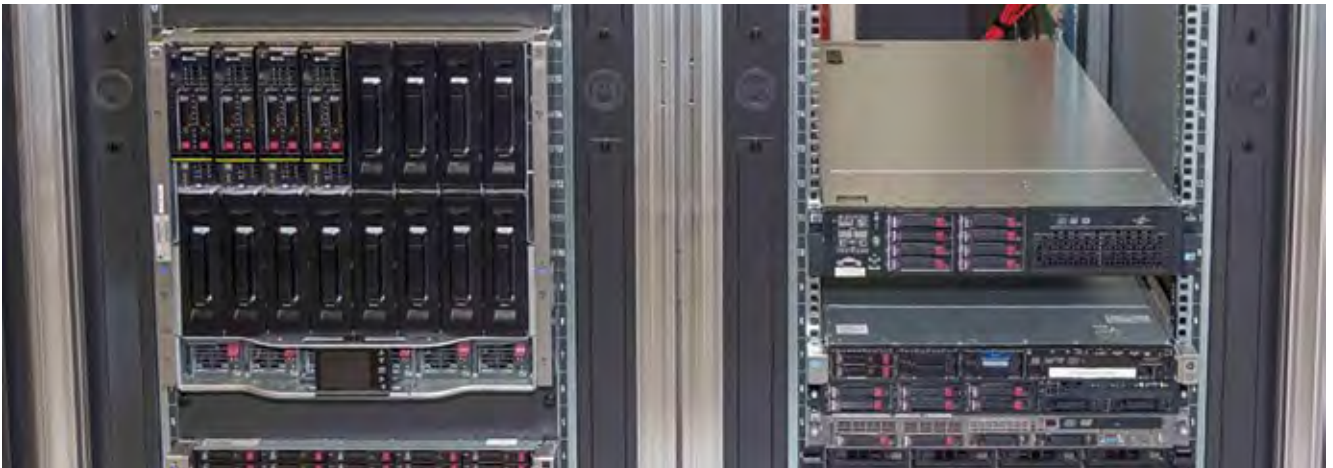
Rechenzentrum Raum 1, Rackausbau 1. Stufe, ELCON
