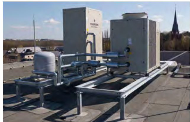
Klimageräte auf dem Firmendach von ELCON
